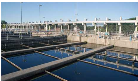
上下水道システム
