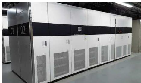
受変電システム (UPS)
