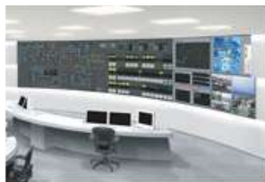
監視制御システム
