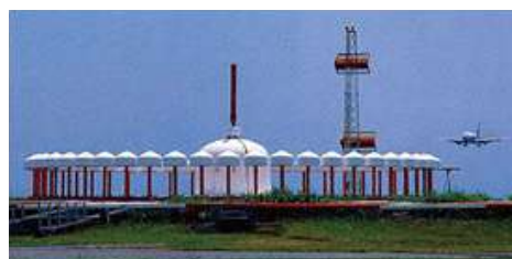
航空管制システム
