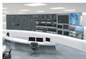
監視制御システム
