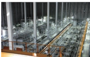
増設MRRS™（増設多核種除去設備）
