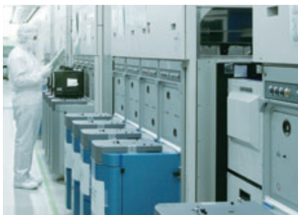
半導体工場のクリーンルーム。局所空調方式でエネルギー消費を抑制
