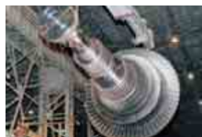
高効率の火力発電用タービン
