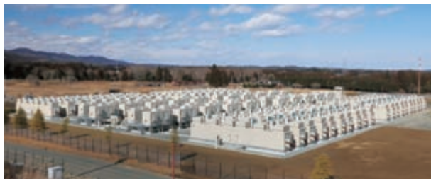
当社のSCiB™が支える南相馬変電所の蓄電池システム
