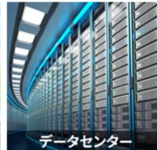
データセンター
