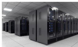
高効率電源 (サーバー等)
