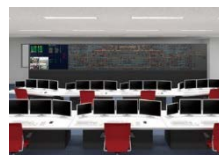
中央給電 指令所システム
