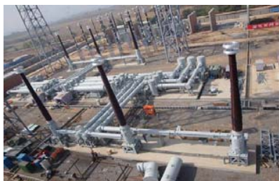
中国UHV(1,100kV)変電プラント IEC※1規格に日本方式採用
