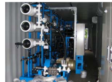
海水淡水化処理装置
