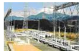
ガス絶縁開閉装置 (GIS)
