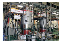
多核種除去設備の吸着塔
