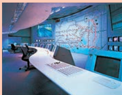
道路交通管制システム
