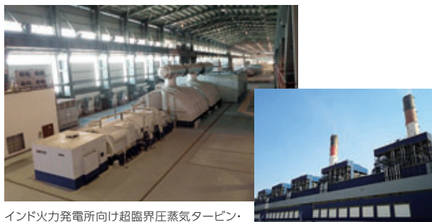
インド火力発電所向け超臨界圧蒸気タービン発電機
