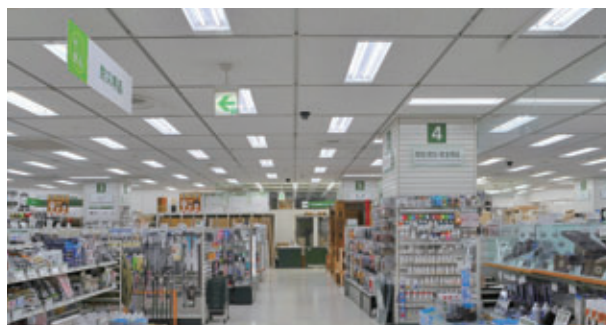
東急ハンズ新宿店3階から7階売場まで採用された「直管形LEDベースライト」
