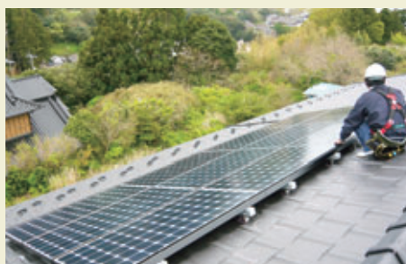
太陽光発電システムを避難所など18か所へ寄贈
