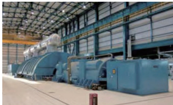
インドネシア タンジュン・ジャティB火力発電所 66万キロワット蒸気タービン発電機
