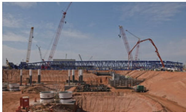
米国ボーグル原子力発電所 ©2012 Southern Company, Inc. All rights reserved
