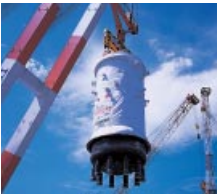
建設中の中部電力(株)浜岡原子力発電所5号機には、当社の最新技術を結集した改良型沸騰水型原子炉が採用されています。写真はその压力容器設置の様相です。
