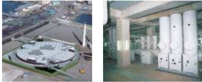
当社が主要変電機器を納入した世界初の500kV地下変電所となる東京電力(株)新豊洲変電所が運転を開始しました。
