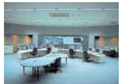
本上下水道システムは、最新の監視制御システムを採用し、信頼性の向上を図るとともにオペレーターの移住空間を意識し、快適で操作性の優れた監視室となっています。
