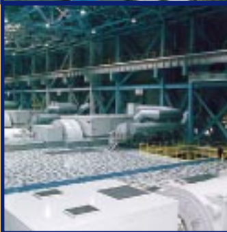
98年12月総合運転を開始した、中部電力(株)新名古屋7号系統コンバインドサイクル発電所(写真上・下)
