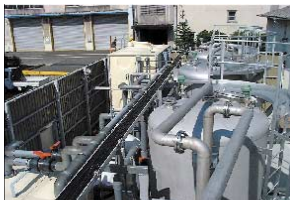
揚水浄化装置の一例
