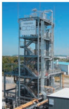
CO 2 分離回収プラント Carbon Dioxide Capture Plant
