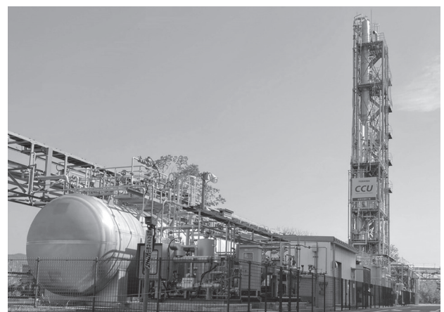
図3. 佐賀市清掃工場CO 2 分離回収プラントの全景
