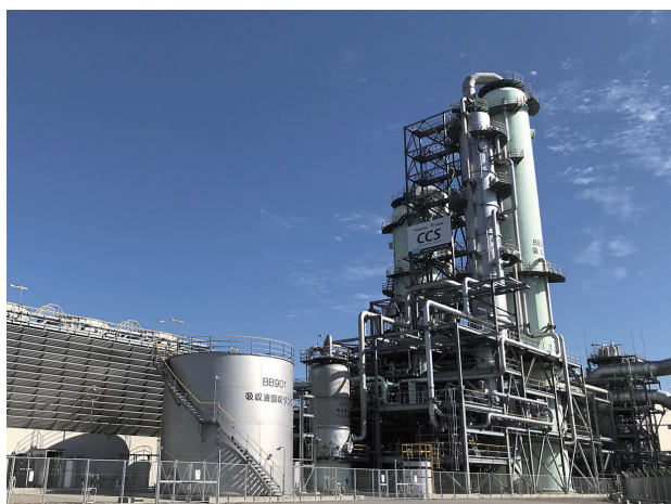
図2. 大規模CO 2 分離回収実証設備（環境省プロジェクト）
