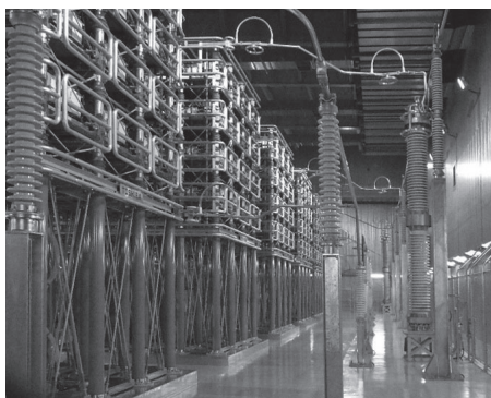
図2. 新北本連系設備向け自励式交直変換器
