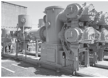
図4. 府中変電所に納入した国内初の電力用SF 6 ガスフリー GIS 2023年に東京電力パワーグリッド(株)府中変電所にて運転を開始した。 Japan's first 72/84 kV GIS using natural origin gas
