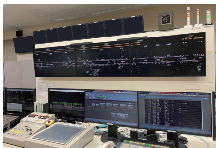
運行管理システムと電力管理システム Train traffic control system and supervisory control and data acquisition (SCADA) system
