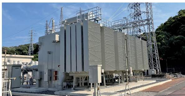
220 kV-250 MVA 主要変圧器 220 kV-250 MVA main transformer
