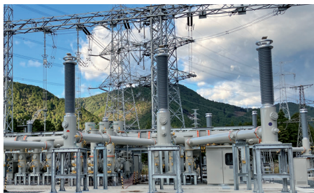
300 kV GIS 300 kV GIS
