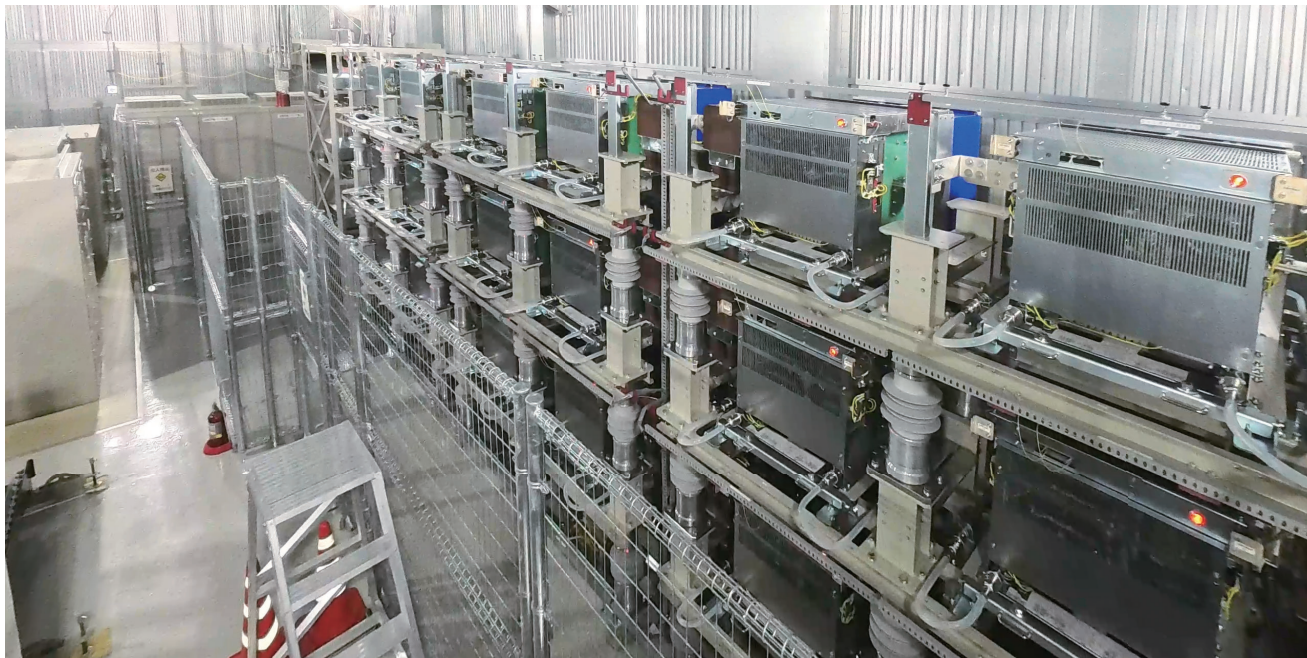
四国電力送配電（株）中村変電所に設置された STATCOM
