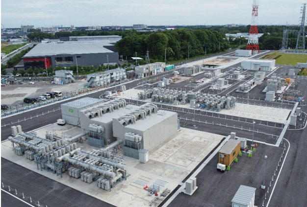
千葉印西変電所 TEPCO Power Grid, Inc. Chiba Inzai Substation
