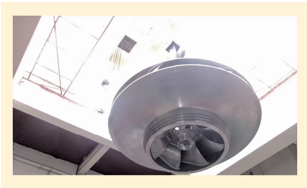
発電ユニットにつり込み中のポンプ水車ランナ Installation of Unit 1 pump-turbine runner at Bajina Basta Pumped Storage Hydropower Plant, Serbia
