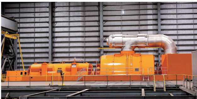
更新後のカライド発電所 C4 号機タービン及び発電機 Upgraded turbine and generator at Callide Power Station Unit C4
