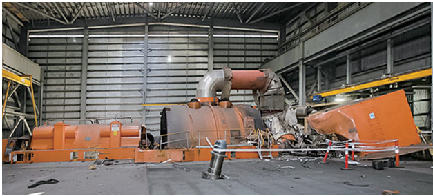
事故発生直後のカライド発電所 C4 号機タービン及び発電機 Turbine and generator at Callide Power Station Unit C4, Australia immediately after incident
