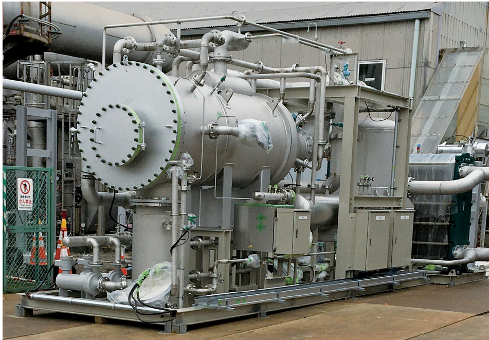
100 kW級バイナリー発電実証試験機 100 kW-class binary-cycle power generation test unit
