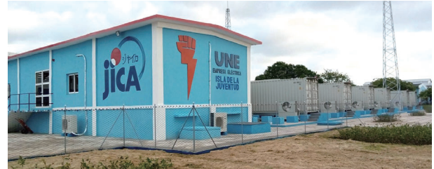
電気室と蓄電池コンテナ
