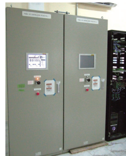
電気室の蓄電池制御盤(手前)とEMSサーバー(奥)
