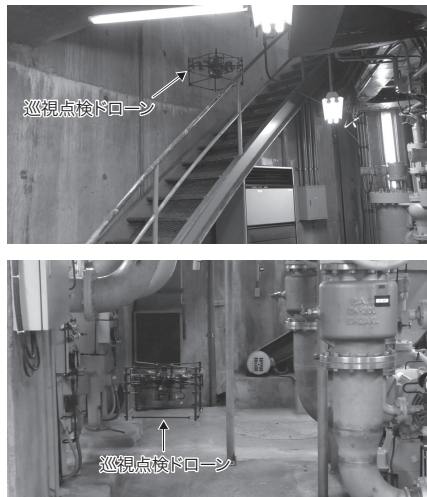
図6. 平山発電所において巡視点検ドローンが飛行する様子 点検経路に設定した階段(上)や狭い通路(下)を通過できることを確認した。 On-site drone demonstration tests
