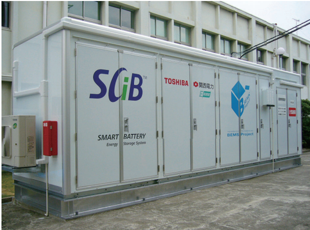
長期実証用の蓄電池システム（関西電力（株）尼崎実験センターで現在も運用中）
