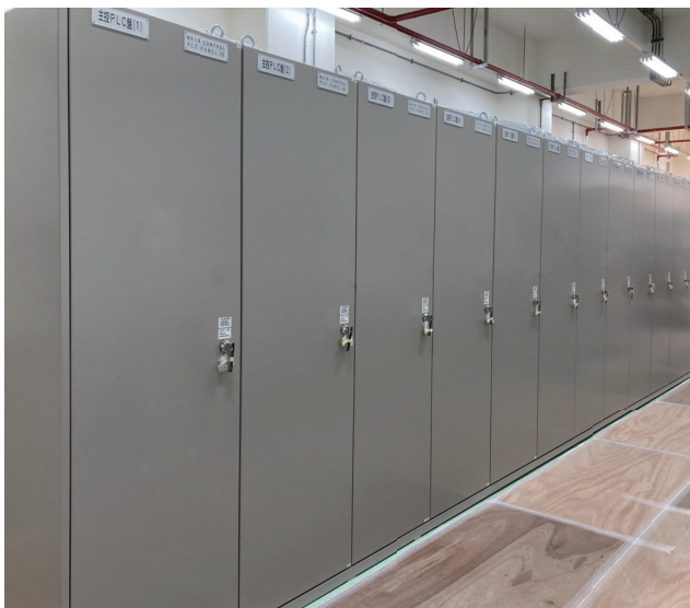
台湾高速鉄道 新設の配電盤 New control and relay panel for Taiwan High Speed Rail
