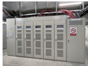
変電所内に設置されたTESS TESS installed at Line 6 substations
