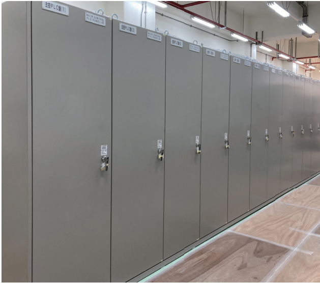
台湾高速鉄道 新設の配電盤 New control and relay panel for Taiwan High Speed Rail
