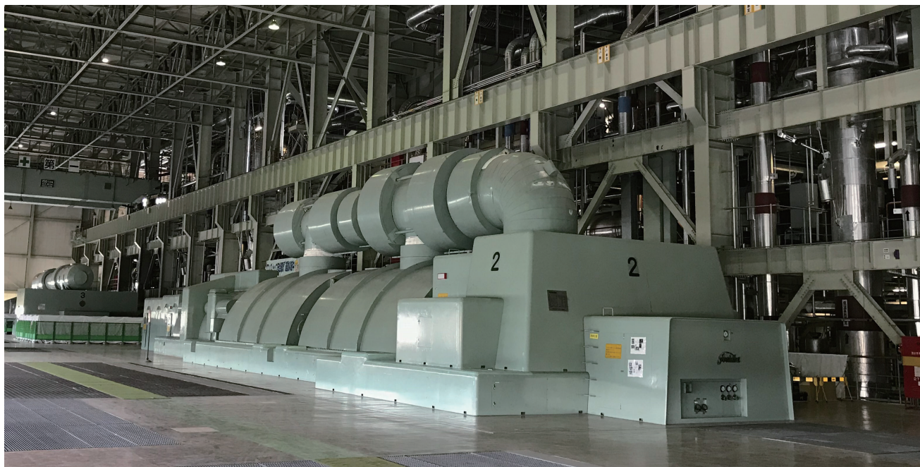
更新後のタービン及び発電機
