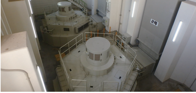
宮崎県企業局 渡川発電所の水車発電機 Hydraulic turbine generator for Miyazaki Prefecture Enterprise Bureau Dogawa Hydroelectric Power Station
