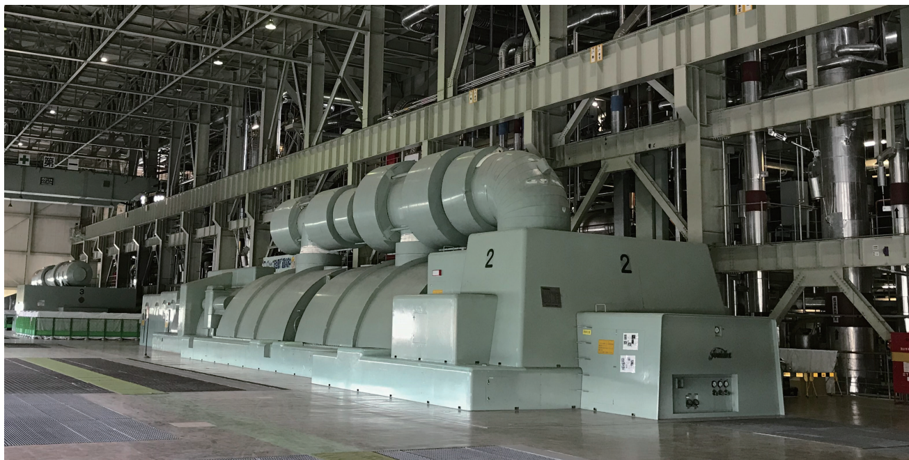
更新後のタービン及び発電機
