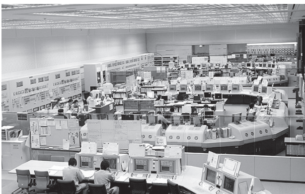
図2. 六ヶ所再処理工場 中央制御室
