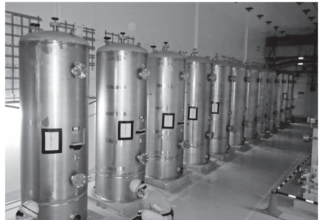
図5. 廃ガス貯留設備(全13基)の外観
