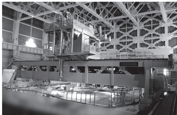
図2. 新たに製作した燃料交換装置
