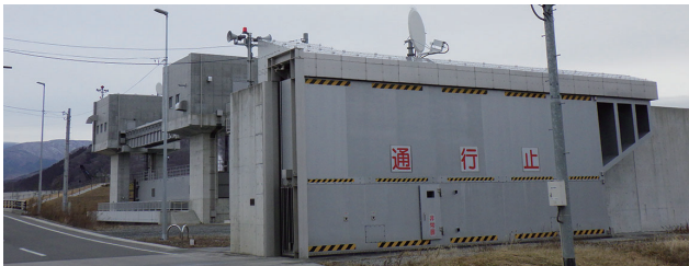
野々田地区の水門・陸閘設備
