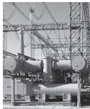
図 1. 新佐原変電所の 550 kV GIS
