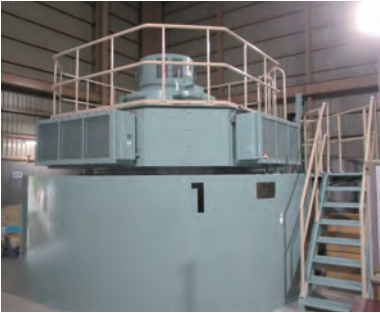
早川第三発電所1号機の水車設備及び水車発電機
