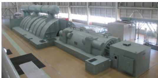
九州電力(株)松浦発電所2号機の蒸気タービン・発電機 Steam turbine and generator for Matsuura Power Station Unit 2 of Kyushu Electric Power Co., Inc.
