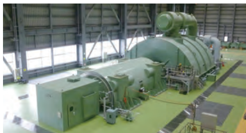
東北電力(株)能代火力発電所3号機の蒸気タービン・発電機 Steam turbine and generator for Noshiro Thermal Power Station Unit 3 of Tohoku Electric Power Co., Inc.
