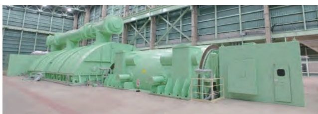
鹿島パワー(株)鹿島火力発電所2号機の蒸気タービン・発電機 Steam turbine and generator for Kashima Thermal Power Plant Unit 2 of Kashima Power Co., Ltd.
