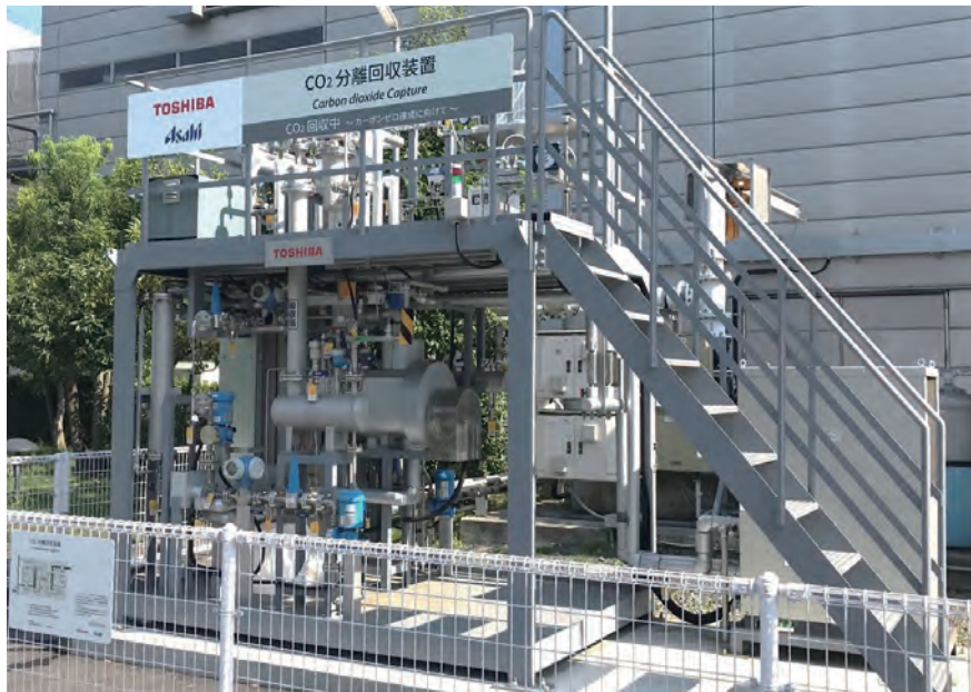
CO 2 分離回収試験装置
