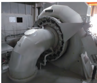
矢代川第一発電所の 水力発電設備
