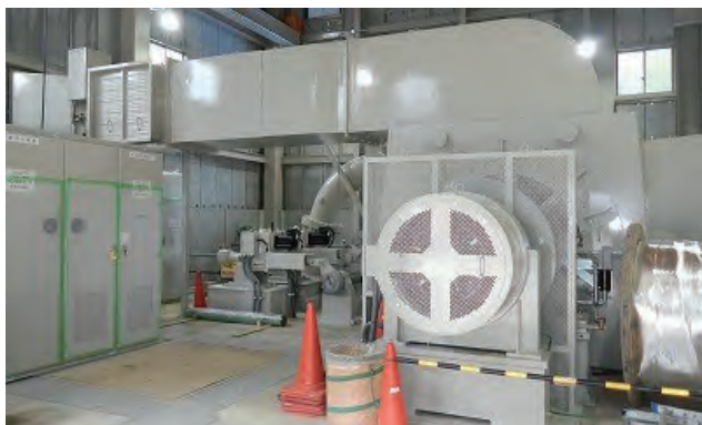
矢代川第二発電所の水力発電設備
