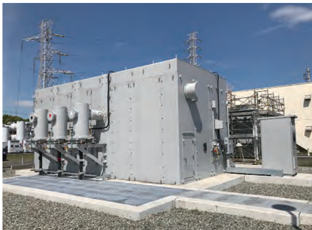
南川崎変電所 275 kV ガス絶縁分路リアクトル 275 kV gas-insulated shunt reactor for Minami-Kawasaki Substation of TEPCO Power Grid, Inc.
