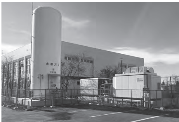
図9. 白糠町温水プールの実証設備
