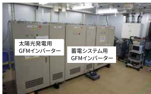
実機検証したGFMインバーター
