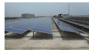
3号館屋上の太陽光パネル
