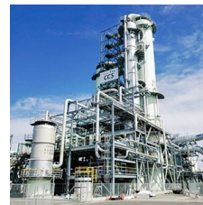
大規模BECCS対応設備
