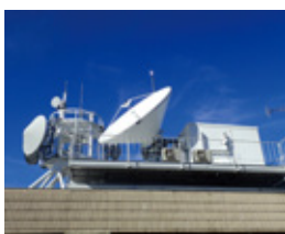
防災通信システム
