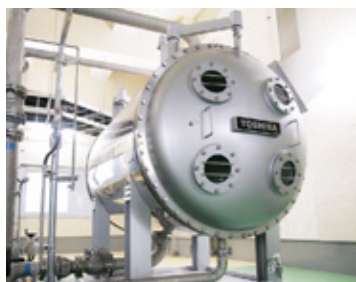
オゾン発生装置
