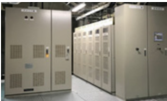
直流鉄道用電力システム向け SCIB™搭載 回生電力貯蔵システム (沖縄都市モノレール株式会社)
