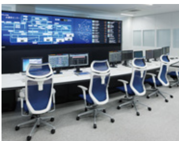
上下水道監視制御システム
