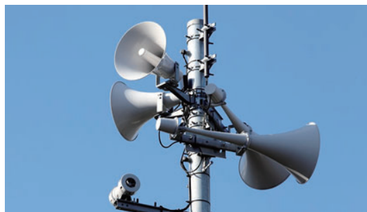
防災無線システム
