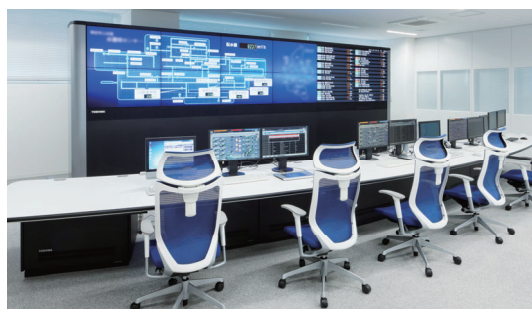
監視制御設備
