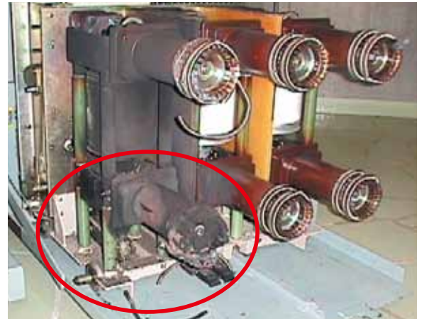
潤滑油劣化による遮断器一次断路部 (PDS) の過熱焼損例
