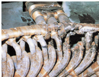
固定子コイル焼損（経年劣化）
