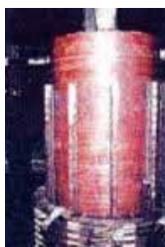
変圧器 絶縁抵抗低下
