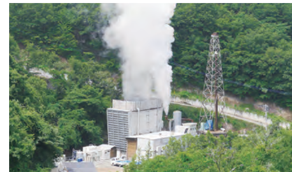
わいた地熱発電所(合同会社わいた会様) Waita Geothermal Power Plant (Waita-kai LLC)
